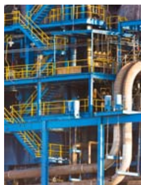
Om ett rör springer läck kan det leda till ett dyrbart stillestånd för processindustrin. Det är därför viktigt att välja produkter som matchar gällande standard. Bild från Depositphotos
